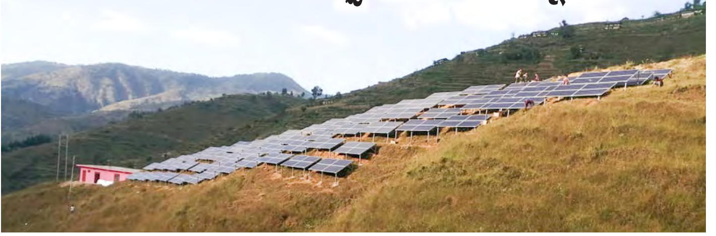
रोल्पाको थवाडस्थित सोलार प्लान्ट ।
